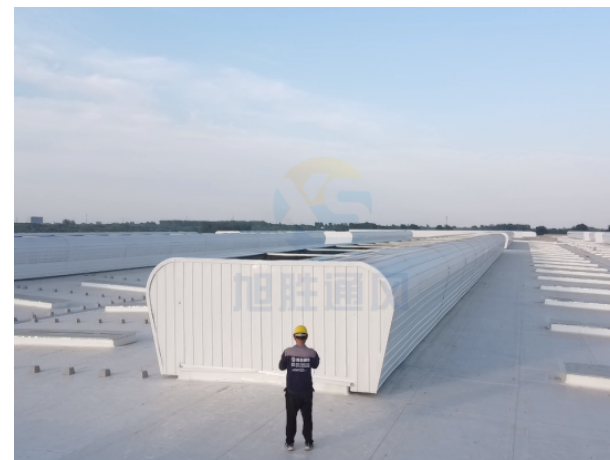
安徽合肥-5型通风气楼
